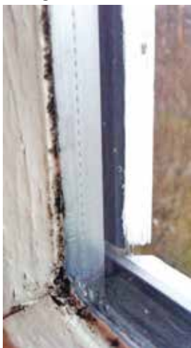
Mugg og råte, foto: Morten Granhaug/BFO
