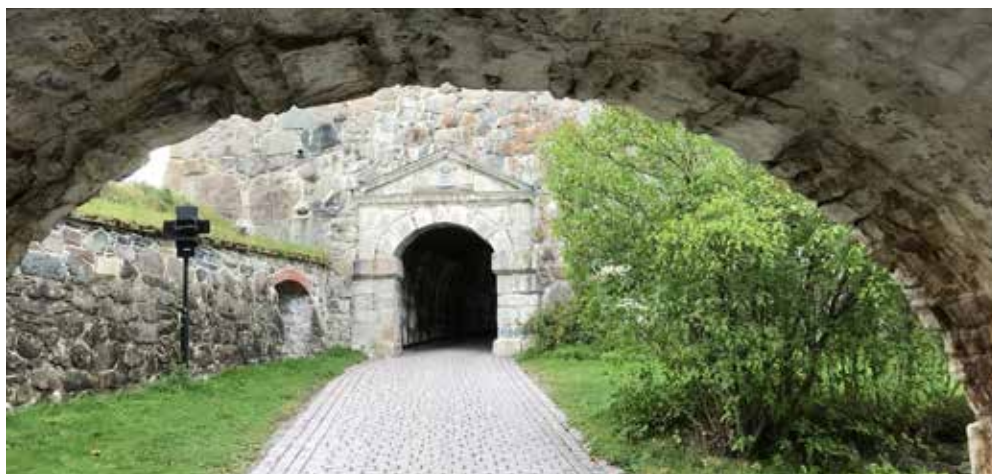
Øverst på ønskelisten for oppussing er hovedporten. Den er i dårlig forfatning og er stivet opp med jernstenger for å hindre at stein faller i hodet på folk. Arbeidet med kasemattene er beregnet til å beløpe seg til 55 millioner kroner. For ytre arbeid med Arsenalet er prislappen 5 millioner kroner.
