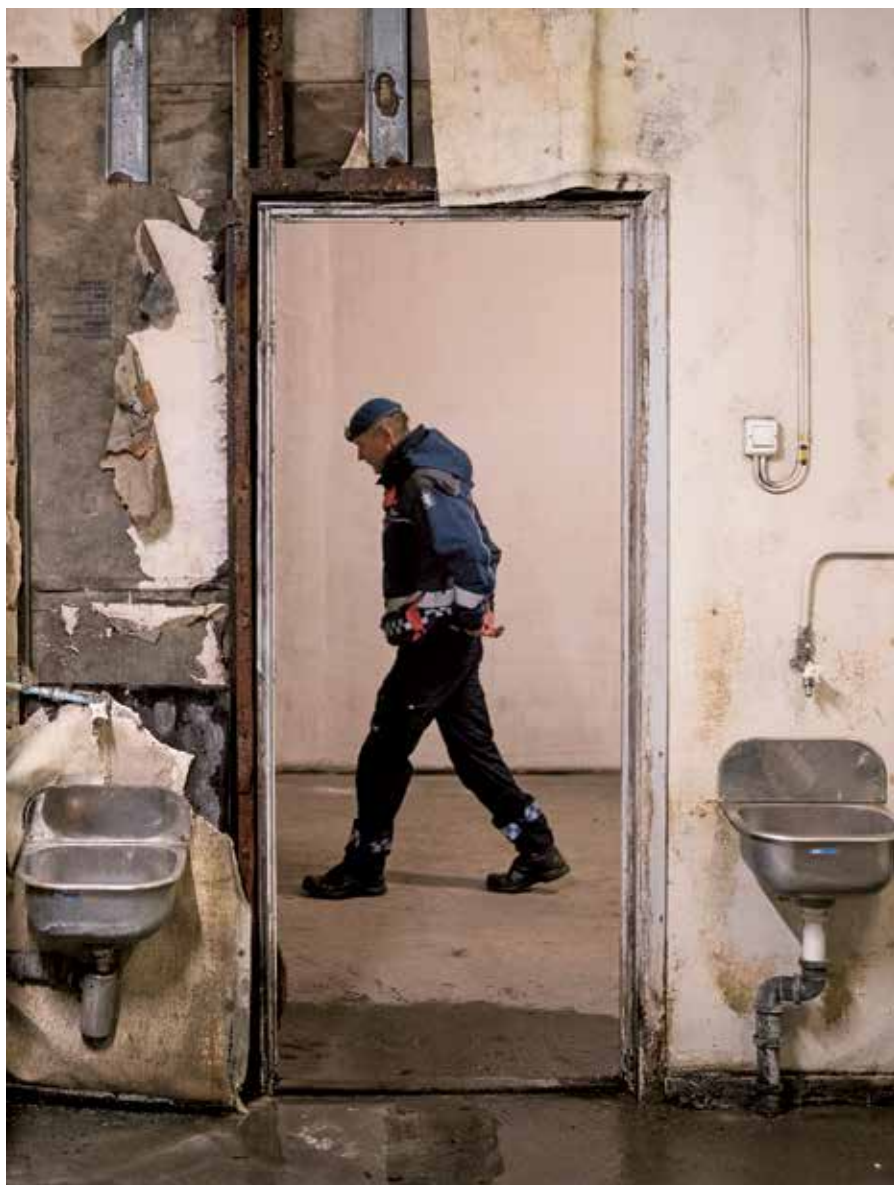
Standarden er lav, og fasilitetene bærer preg av forfall. Det drypper fra taket, og noen vegger har råtnet bort. Likevel beskytter tilfluktsrommet fortsatt like godt mot det det er designet for, betrygger Rune Larsen fra Sivilforsvaret.
