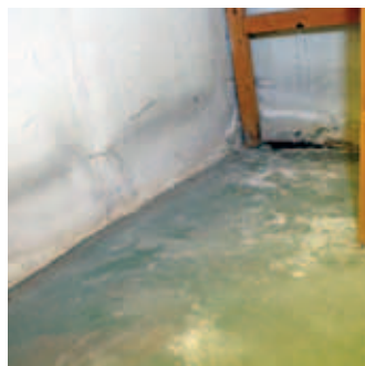
Fuktmerker på vegg og gulv i kjeller.
