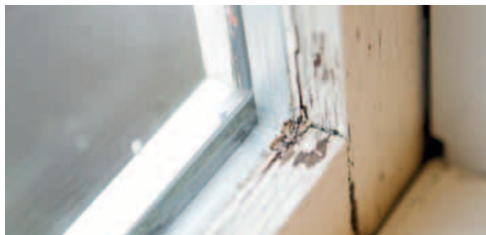
Vinduskarm - her kan man lett stikke neglen ned i treverket.
