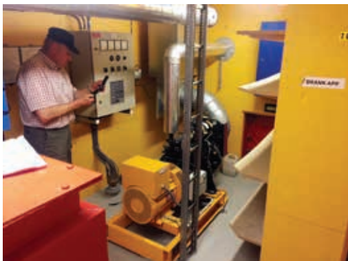
Teknisk rom med aggregat er som nytt og diesel tanken er \frac{3}{4} full.
