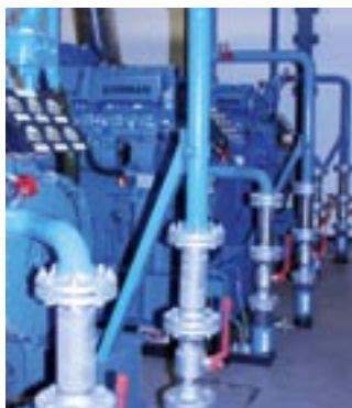
Skipsmotorer brukes som nødaggregat til fjellanlegget.
